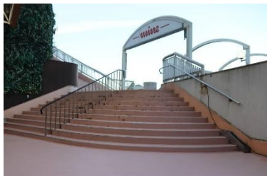
△階段により、車いす・ベビーカー利用者はデッキを実質使えない。
