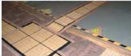
△西口トイレ工事中の段差やガムテープによる固定の甘い点字ブロック。
